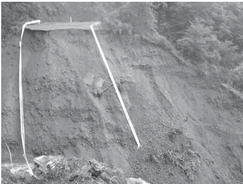
早期復旧が望まれる東津野城川線
