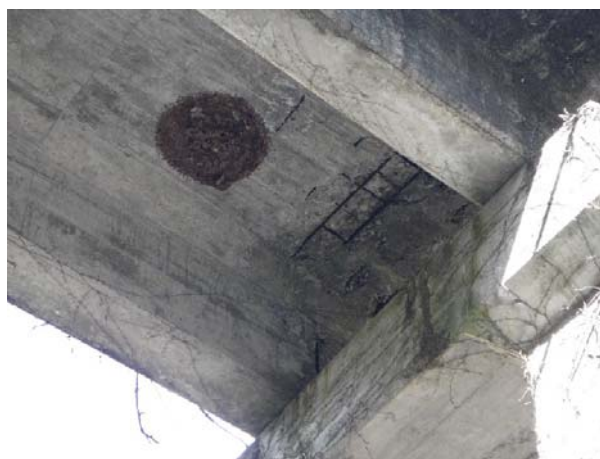
床版鉄筋露出
