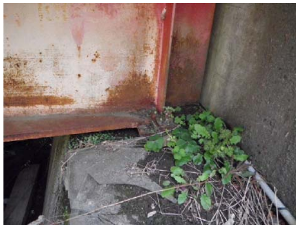
支承機能障害
