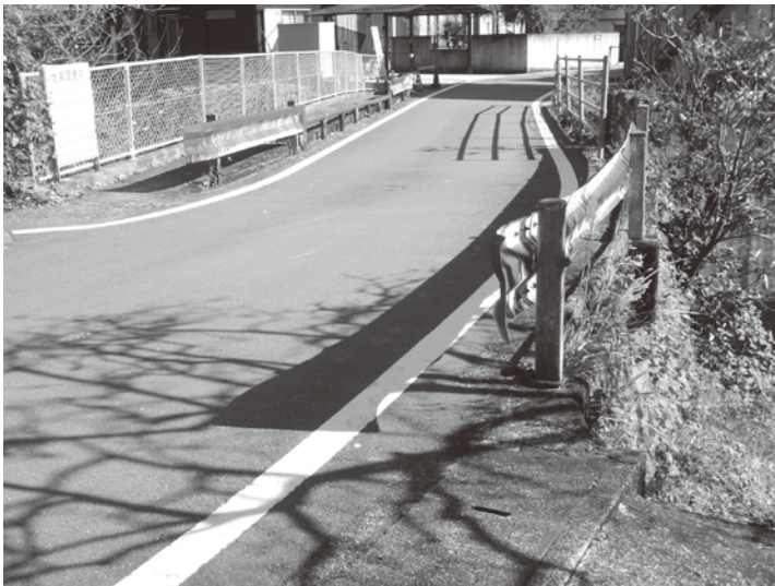
老朽化した永林の「八幡橋」
