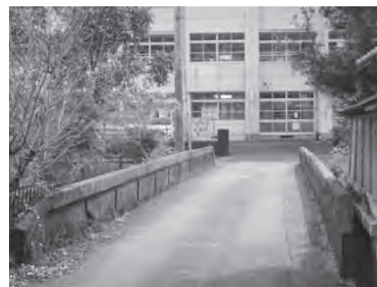
老朽化した「精華橋」
