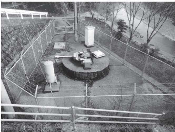
稼働中の簡易水道施設
