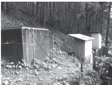
地区の水道施設
