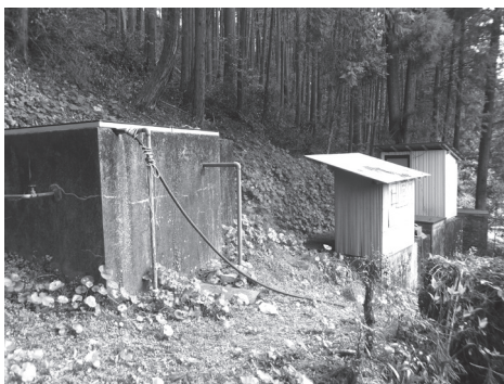
地区の水道施設
