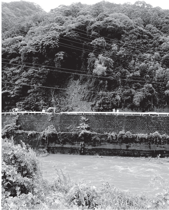
国道 197 号線の滝山の災害現場
