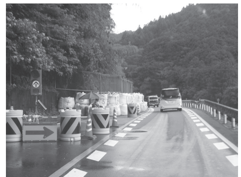
片側通行している災害現場
