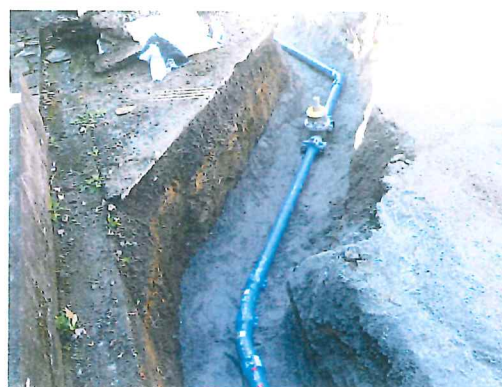
簡易水道の配管
