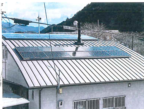
太陽光発電システムを設置した住宅
