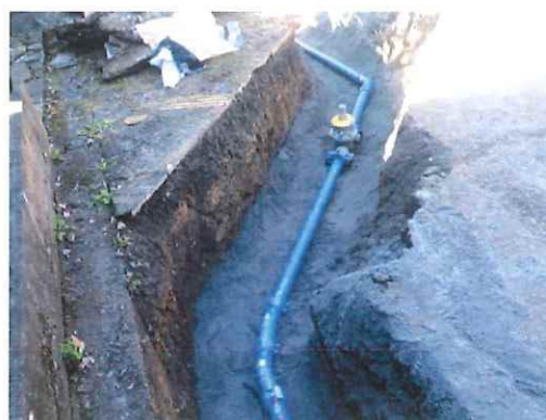
簡易水道の配管
