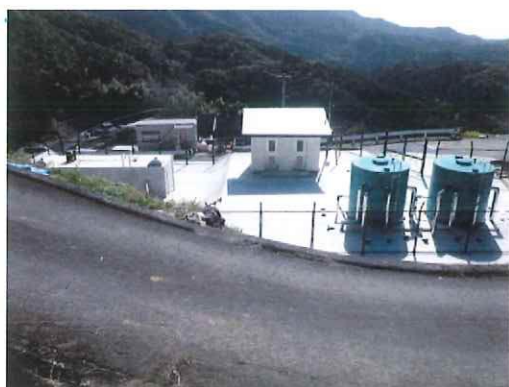
簡易水道施設（樺ノ川地区）
