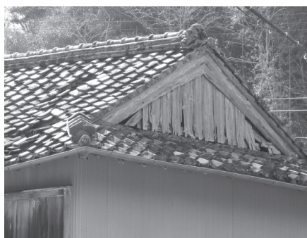
▲撤去が望まれる老朽空き家
