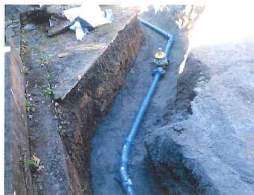
簡易水道の配管
