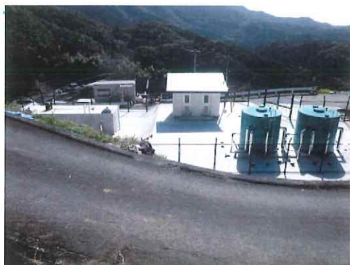
簡易水道施設（樺ノ川地区）
