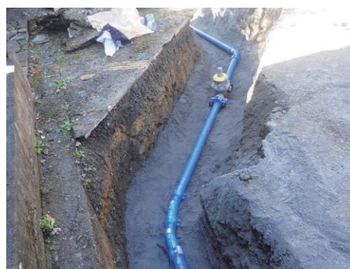
簡易水道の配管
