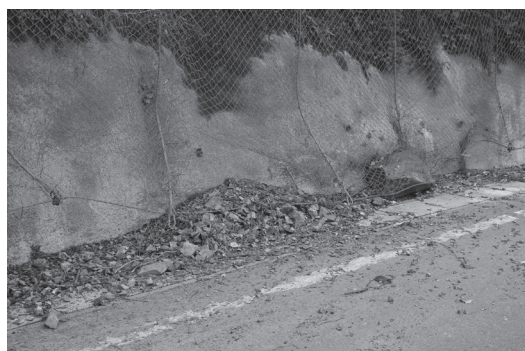
▲落石と土砂崩壊による危険箇所
