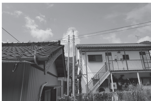
▲老朽化で電柱・配線等工事に支障が
